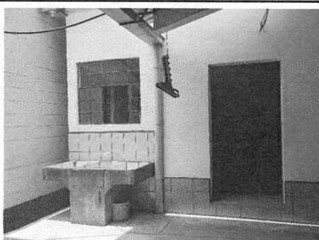
Foto 6: MÓDULO 2: ubicación de la pila en el lugar indicado.
